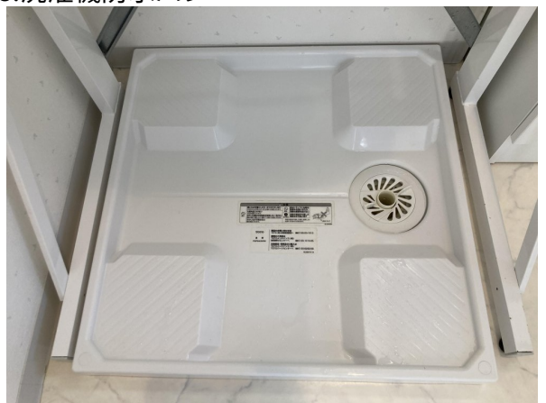
8.洗濯機防水パン
